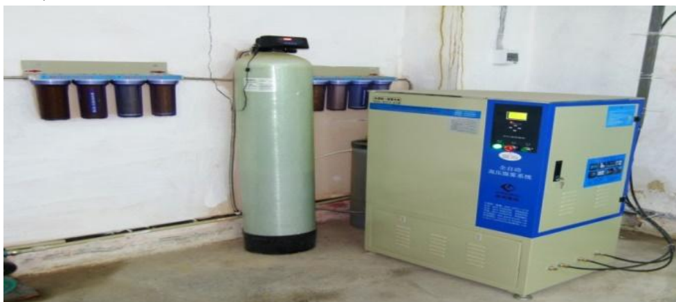
Рисунок 3. – Полностью автоматическая система микро распыления под высоким давлением
